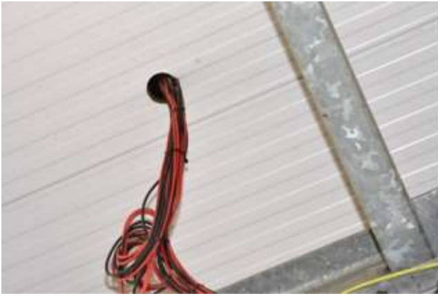
Afbeelding 3.9 Doorvoering van bekabeling die niet voldoet. De bekabeling loopt langs scherpe delen van een overkapping. Plus- en min-kabels lopen door dezelfde doorvoer, terwijl de onderlinge afstand minimaal 10 cm moet zijn. (Bron: Tbo GM).
