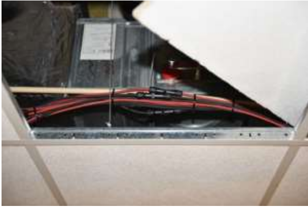
Afbeelding 3.12 Bekabeling boven een verlaagd plafond (Bron Tbo GM)
