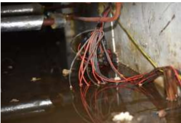
Afbeelding 3.10 Bekabeling met connectoren in een kruipruimte vol met water door een defecte pomp (Bron: Tbo GM)
