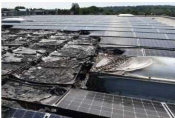
Afbeelding 3.7 Voorbeeld van het risico van zonnepanelen nabij lichtkoepels bij onvoldoende vrije ruimte (Bron: Tbo GM)
