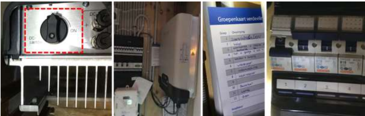
Afbeelding 1.4 Omvormer in een meterkast. Na stormschade is de DC-schakelaar is omgezet en de betreffende groep uitgeschakeld (Bron: J. Ebus)
