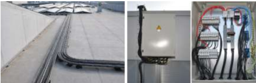
Afbeelding 3.11 Kabeltracé met transportkabels en een niet automatische stringbox met DC schakelaar om een dakvlak met panelen te ontkoppelen (Bron: Tbo GM)
