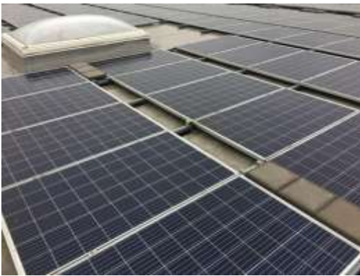
Afbeelding 3.2 Op-dak PV-systeem op een bedrijfshal, vlak vanwege windbelasting (Bron: Tbo GM)
